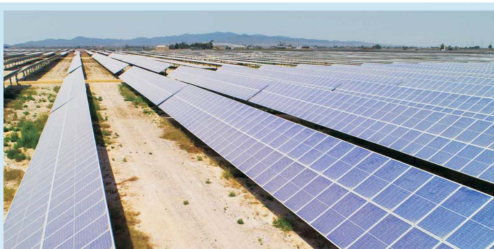
Macroplanta de energía fotovoltaica.
