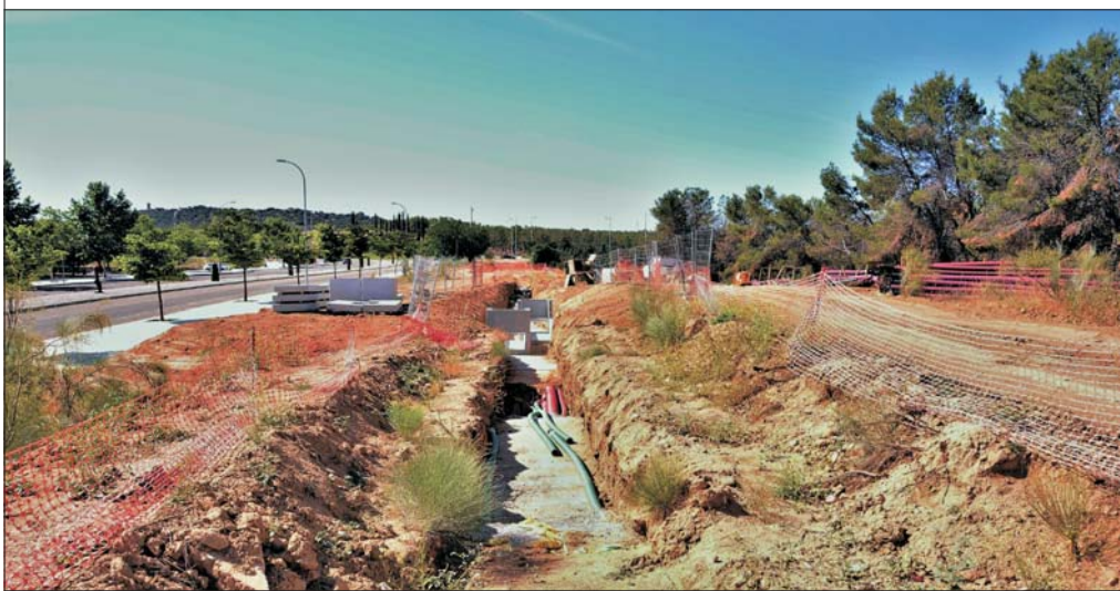
La línea de alta tensión retrasa la apertura total del hospital. Foto José Luis González.
