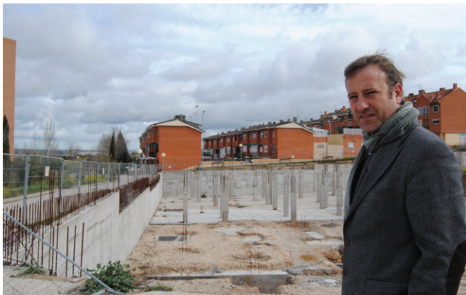
Estado de la parcela M-72 denunciado en varias ocasiones.
