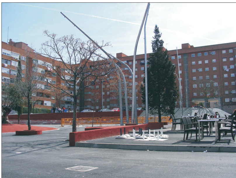
Los focos sobre las columnas y la obra de la fuente deberían estar acabadas.
