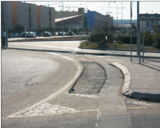
Estado de los zanjeados con zonas cortantes durante meses.
