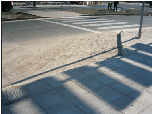
Suciedad, polvo, falta de limpieza barrizales ha sido lo común en el desarrollo de la obra.
