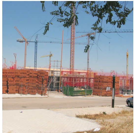
El depósito de los materiales en el mismo poste de parada es el lugar menos adecuado.
