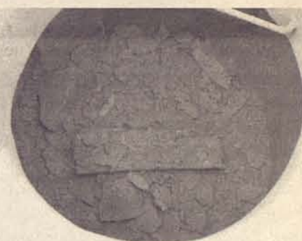
Detalle de los escombros en la alcantarilla
