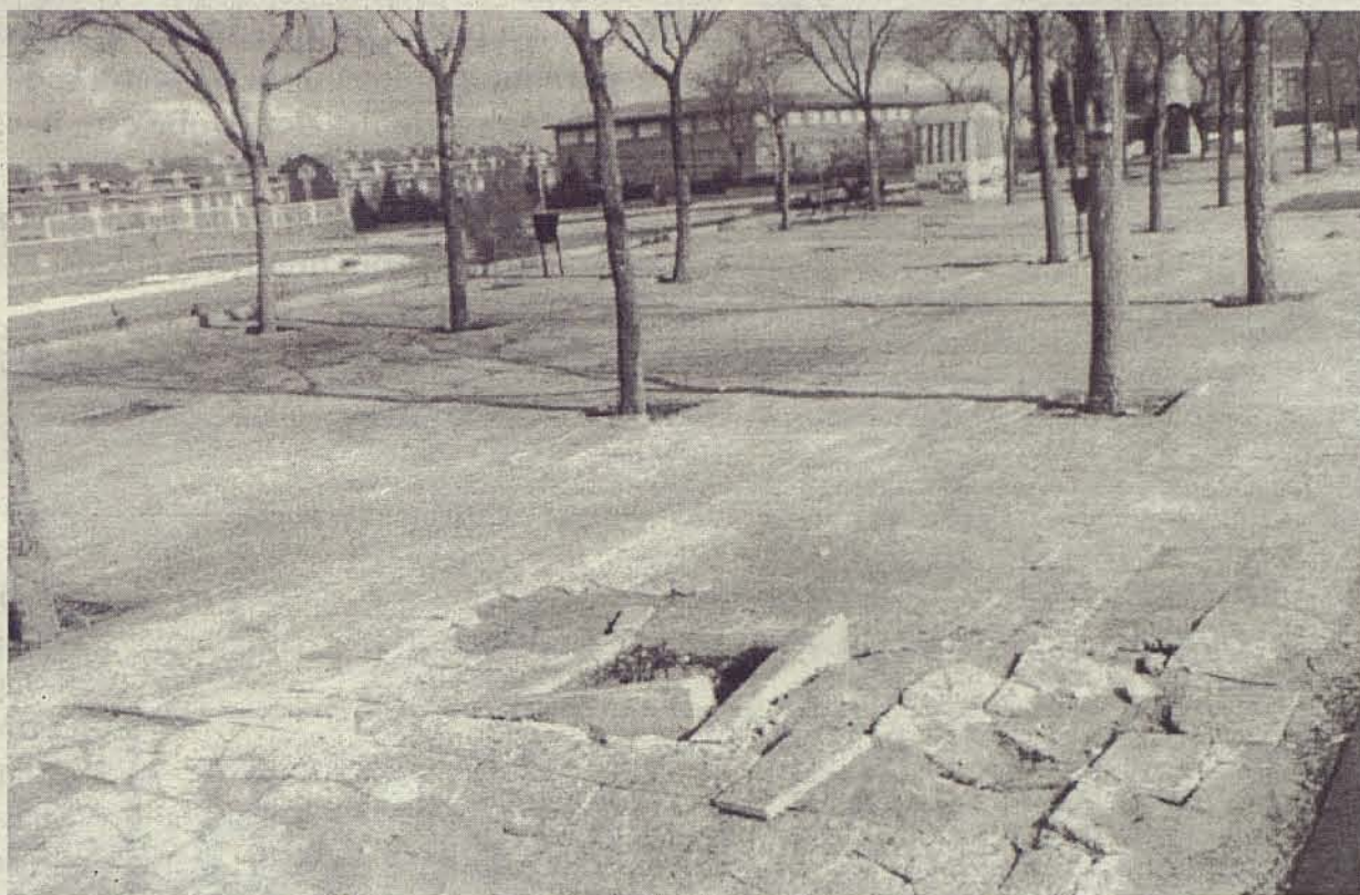
Durante el pleno se pidió la reparación de la peatonal Julián Besteiros.
