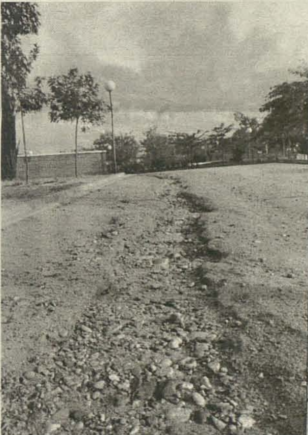
El Parque de los Alcázares necesita su tercera remodelación en su corta historia, si llueve ocurre esto, y por otra parte su circuito de riego está inutilizado.
