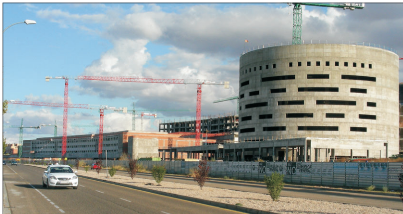
Obras paralizadas del nuevo hospital.
